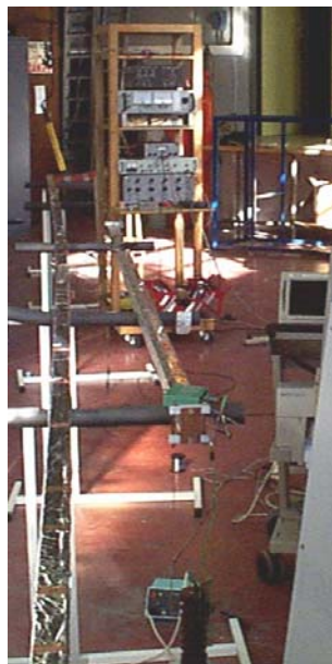
Photo 1 : Exemple de barres haute tension
