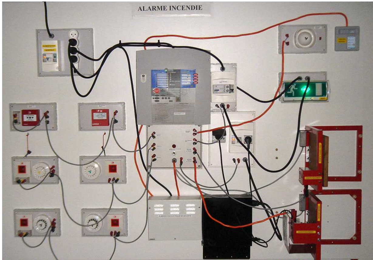
Fig. 1 : Photo de l'installation réelle
