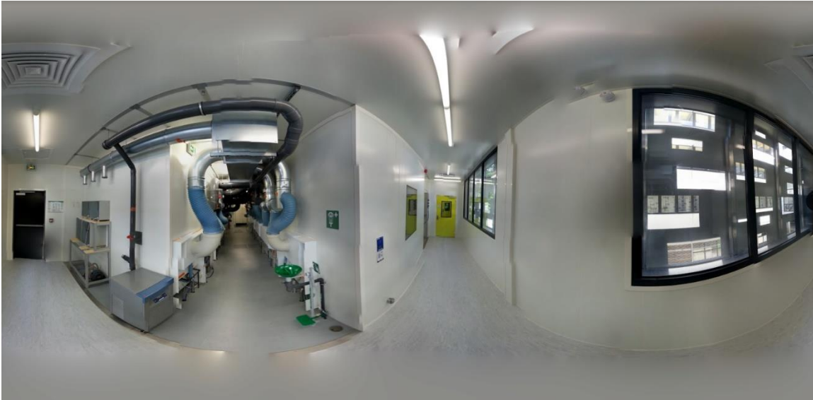
Fig.4. Photo à 360° des locaux techniques : aspiration des hottes.
