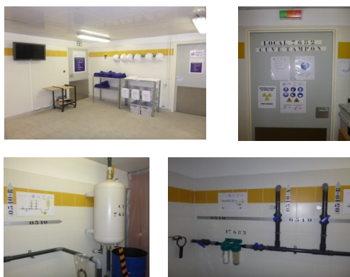
fig 1 : Vestiaires, Zone contrôlée
