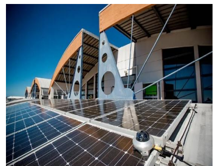
Figure 4 : Photographie de la centrale photovoltaïque étudiée dans le TD.
