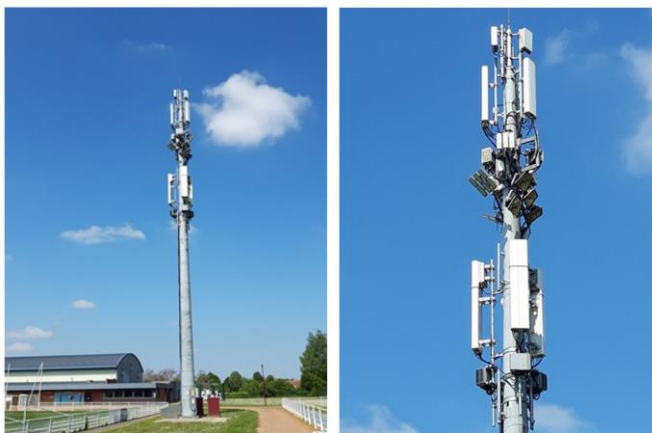
Fig.1. Illustration d'un vrai site relais de téléphonie mobile. L'illustration montre l'exemple d'un site réel situé sur un stade de la ville de Templemars située à quelques kilomètres du campus scientifique de la ville de Villeneuve d'Ascq dans le département du Nord.
