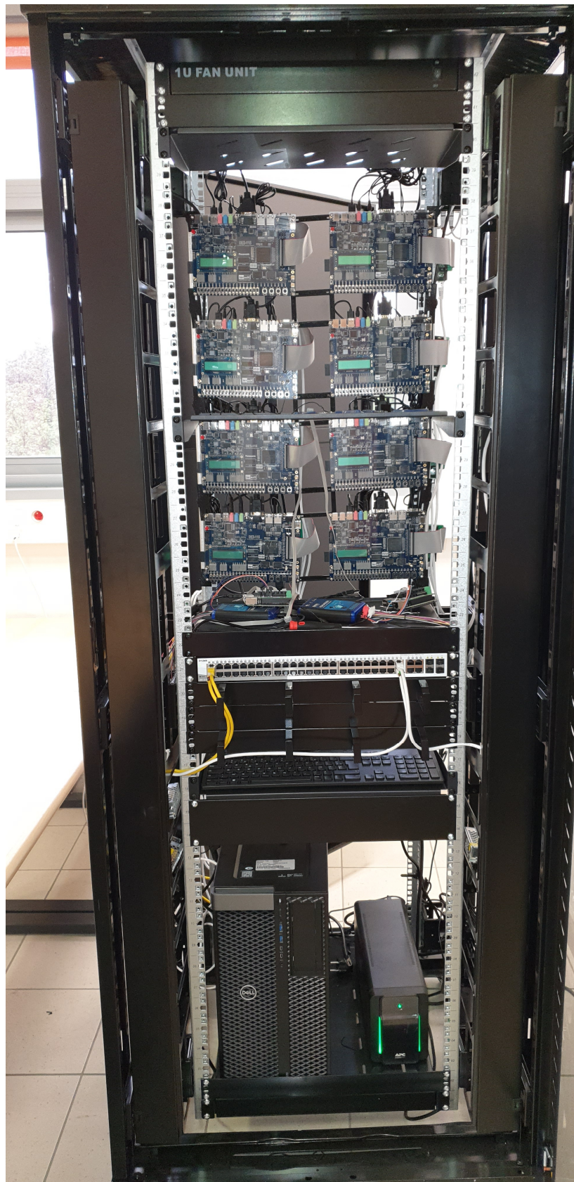
Figure 5. Baie de brassage qui contient les 8 TPs FPGA qui sont accessibles à tous nos étudiants.
